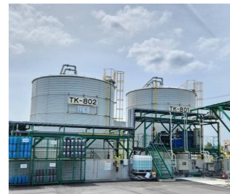
苛性ソーダタンク、塩酸タンク
