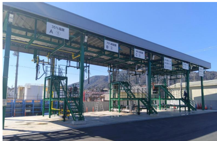
タンクローリー用出荷設備
