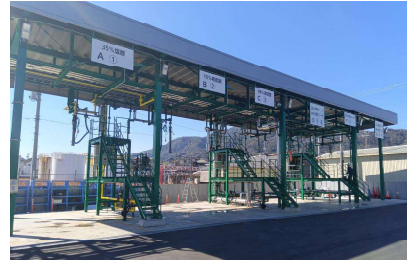
タンクローリー用出荷設備
