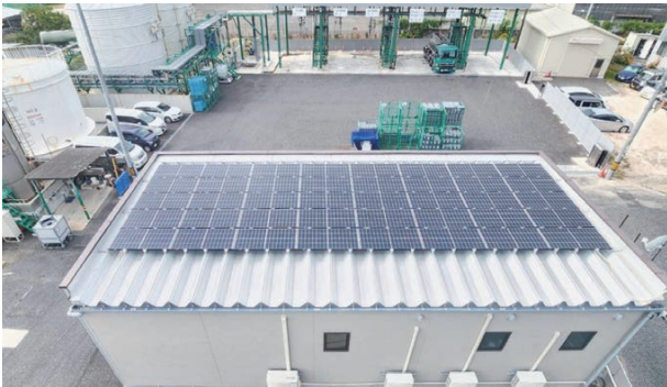
広島大野ケミカルセンターの太陽光発電設備
