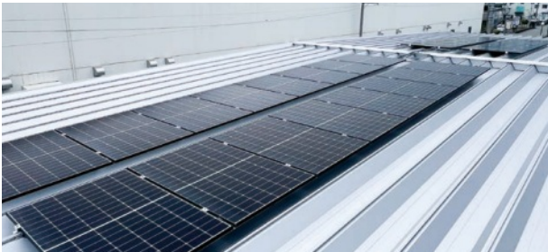
富士物流倉庫の太陽光発電設備
