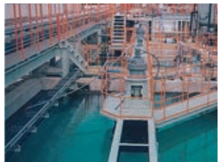
廃水処理設備
